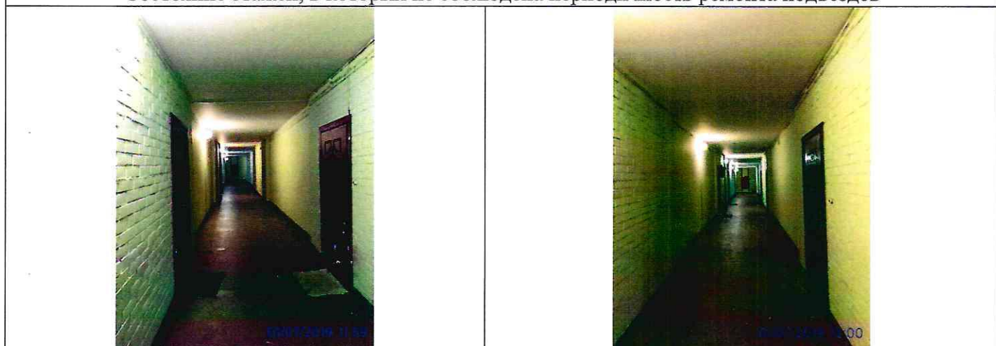
Состояние этажей, в которых не соблюдена периодичность ремонта подъездов
